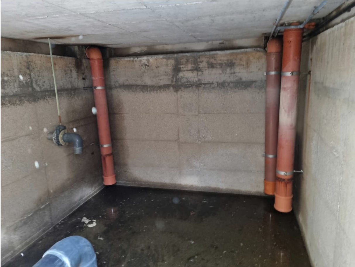
Schwallwasserbehälter alle 3 Becken – keine Abdichtung, Materialleitungen nicht schwimmbadkonform
